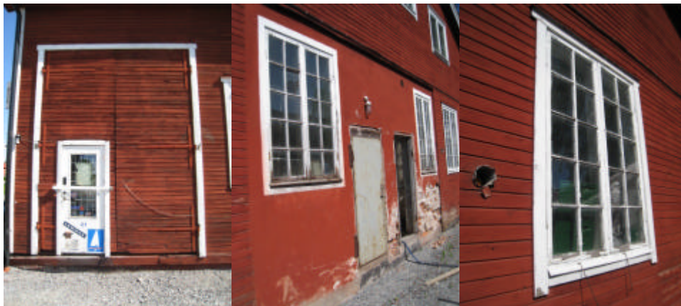
Hus H. Från vänster: Bevarad ursprunglig port med sekundär infälld dörr, den putsade fasadytan öster samt ett ursprungligt tätspröjsat fönster.
