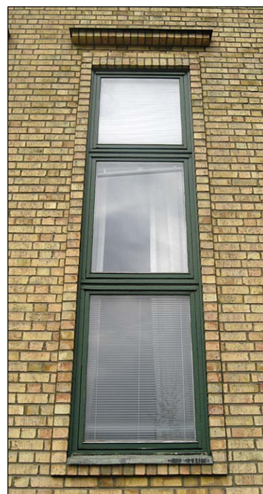
Ett av tingssalspartiets höga fönster, inramat av den murade omfattningen. Ovanför fönstret sitter ett droppbleck i koppar på en murad list. Nbm acc.nr 2005:219:12
