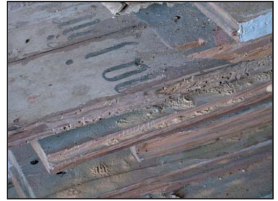
Figurmålade takbräder från gamla kyrkan, staplade i tornkammaren. Pågående angrepp av strimmig trägnagare.
