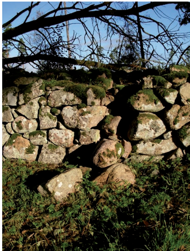
Skada på norra muren.
