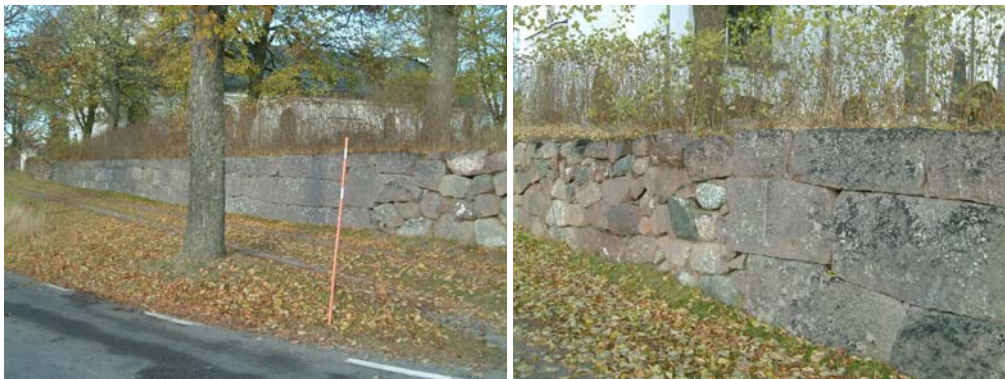
Den västra muren där en bit av mittpartiet har blivit lagad.
