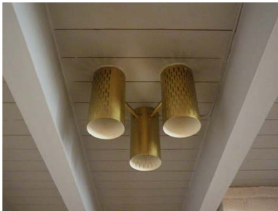
Armaturl under läktaren.
