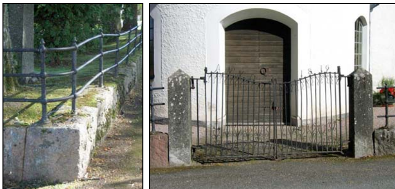
Omgärdning av järnrörsstaket på stensockel. Huvudgrinden är liksom de övriga grindarna smidda och dekorativt försedda med årtal upptill.
