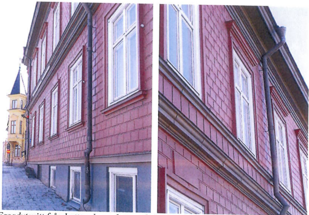
Fasadutsnitt från bottenplan och övervåning, med högre och mer markerade fönster i övre våningen.
