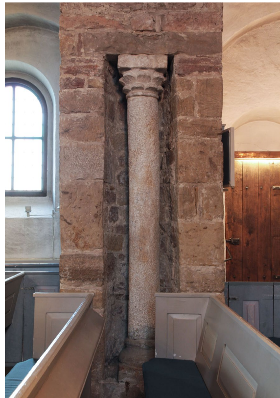
Nischkolonnen i den västra arkadpelaren tros anspela på kolonnerna vid ingången till Salomos tempel.
