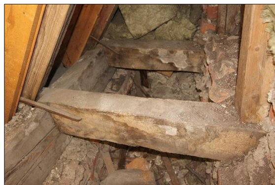
Stickbjälkarna utgjorde tidigare bindbjälkar i en äldre konstruktion. Bjälkarna högs av vid valvslagningen. Virket utgörs av skarpkantad sprätthuggen ek. Fyndförande kulturlager omger remstycken och stickbjälkar.
