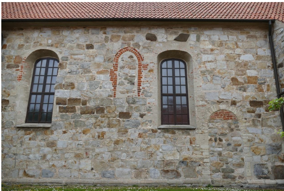
Kyrkan putsades under 1800-talet. När putsen successivt togs ner under 1950-talet kom flera intressanta byggnadsarkeologiska spår i dagen. Bilden visar kyrkans norra fasad med medeltida igenmurad norrport med kalkstensomfattning, samt ett äldre högt placerat spetsbågigt fönster med tegelomfattning.
