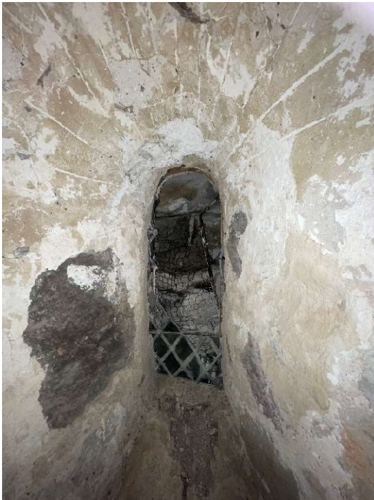
På vinden finns en ursprunglig fönsteröppning bevarad med delar av ett fönsterglas. I putsen över fönströppningen är putsen ristad med "strålar".
